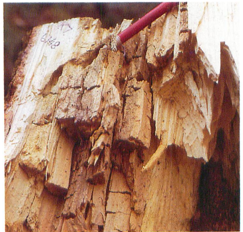
Fig. 3-8. Brown cubical rot.
